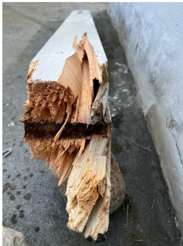
Den nedfaldne bjælke på ca. 3 meters længde.
